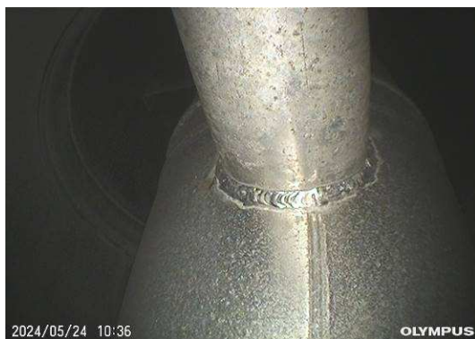
Camerashot RGA ketelaansl. en verbinding CLV systeem
