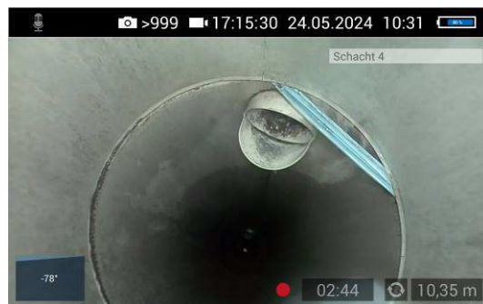
Niet correct afdichtrubber in CLV systeem 4
