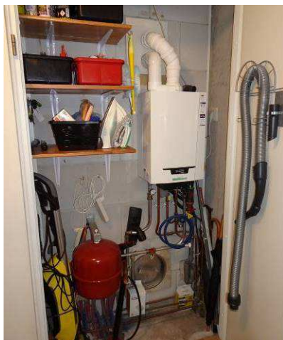
Situatie ketel en inspectiedeksel
