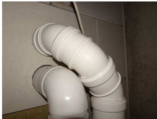
Doorvoering ketelaansluit leidingen en ontbrekende brandmanchets
