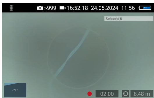
Niet correct afdichtrubber in CLV systeem 6
