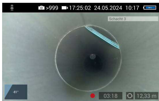
Niet correct afdichtrubber in CLV systeem 3
